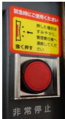
図 5 非常停止押しボタン
